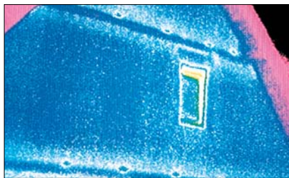
Рис. 9. Термограмма мостиков холода в области опоры перекрытия
